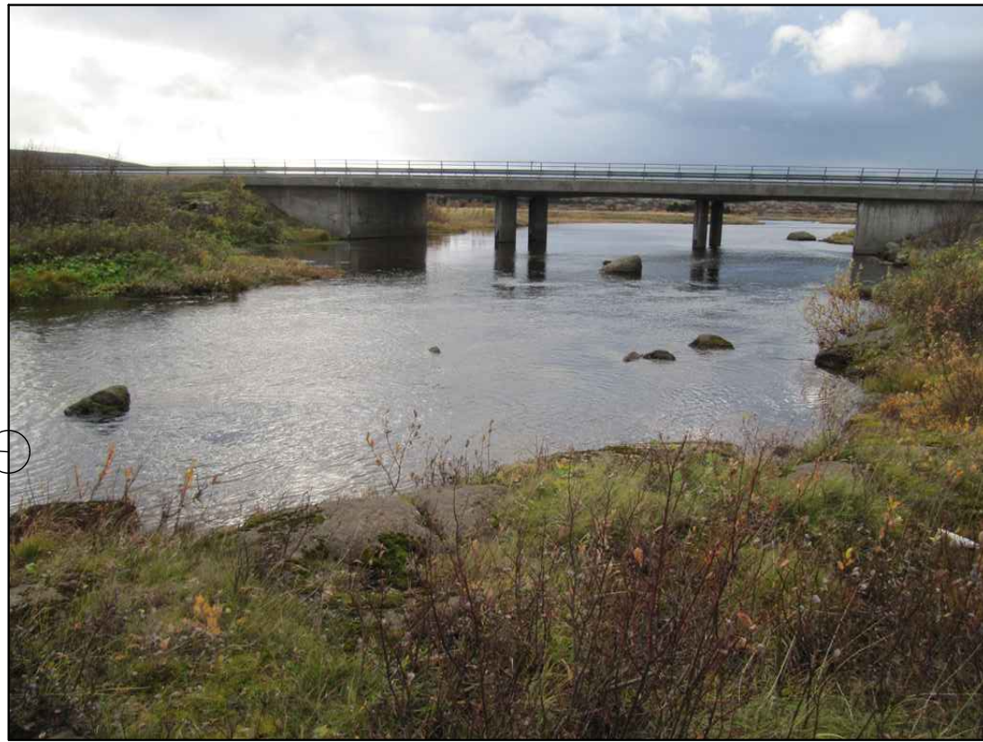
VEGBRÚ YFIR HÓLMSÁ, HORFT TIL SUBURS. REIÐGATA YRÐI UNDIR BRÚNNI VIÐ EYSTRÍ STÖPUL BRÚARINNAR. MÆLD HÆÐ 11. okt FRÁ VATNSBORÐI UPP UNDIR BRÚARGÖLF 3.0 m, SEM GEFUR VATNSHÆÐ Í ÁNNI 1.30 m. SAMKVÆMT RENNSLMÆLINGUM Í HÓLMSÁ ER MEDALRENNSLI 2.15 m 3 /sek SEM GEFUR VATNSHÆÐ 1.42 m. LAGT TIL AD REIÐGATA VERÐI SETT Í HÆÐ 1.60 m, ÞAÐ GEFUR HÆÐ UNDIR BRÚARGÖLF 2.70 m.
