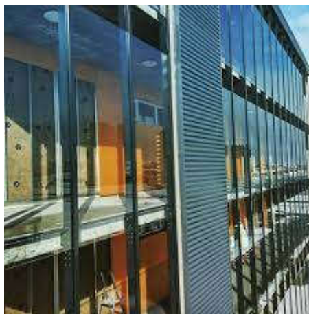
Mynd 3: Dæmigerð lokun á svalangangi er opin að ofan og neðan vegna reyklosunar.
