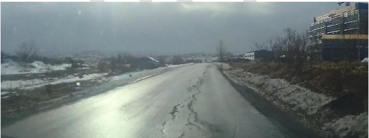
MYND 6 Skemmdir í vegi við Urriðaholt vegna lélegs burðarlags, mars 2022. Hæðarlega vegarins er einnig ábótavant suður fyrir Urriðaholt, m.a. vegna gatnamóta við veginn.
