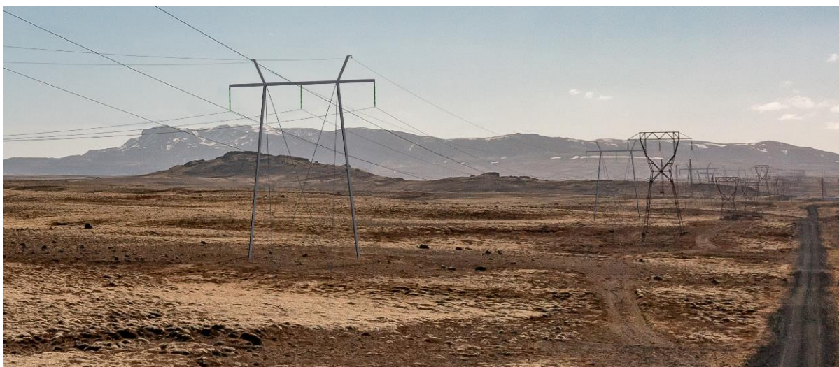
MYND 4 Stöguð stálrörarmöstur sem verða sett upp í KH1 (t.v. á mynd).
