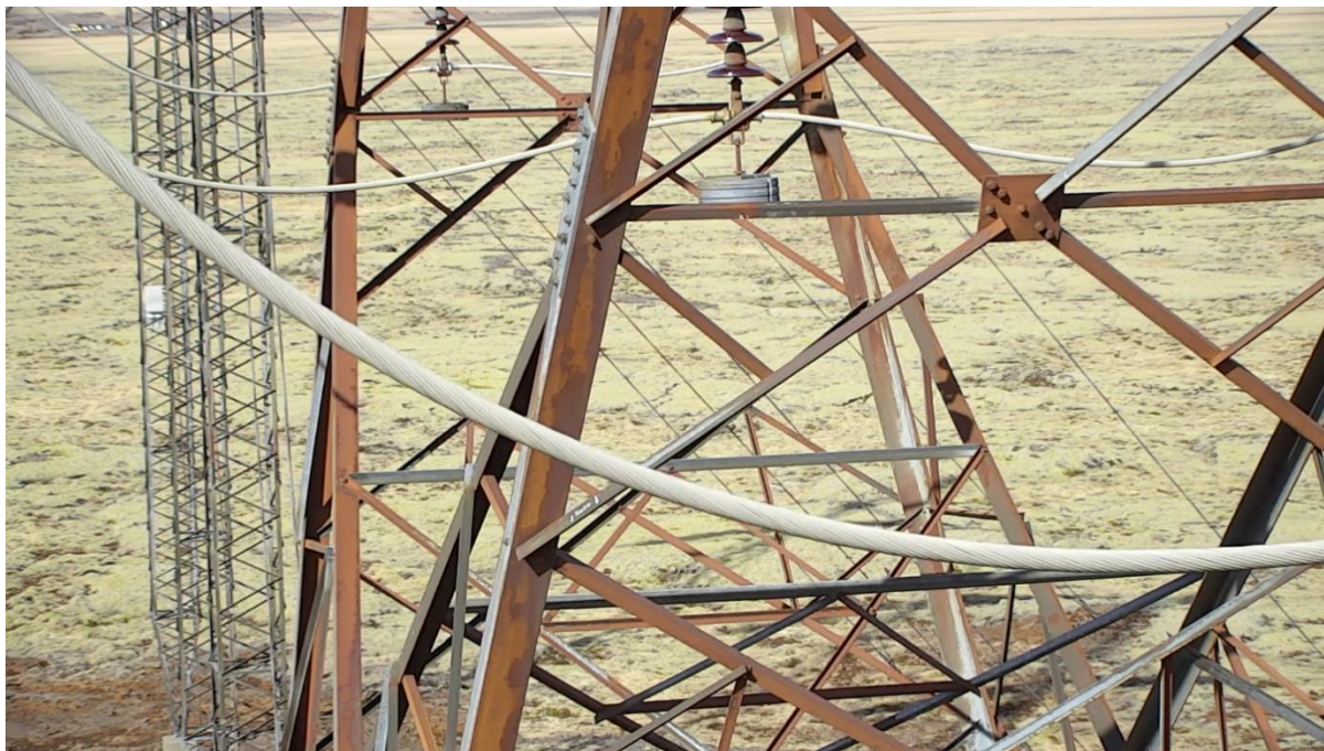
MYND 8 Myndin er frá árinu 2019 og sýnir ryðmyndun í mastri 9 í Kolviðarhólslínu 1 (áður mastur 227 í Búrfellslínu 2) sem stendur 3,5 km vestan tengivirkisins við Kolviðarhól. Þetta er eitt af þeim möstrum sem verður endurnýjað.
