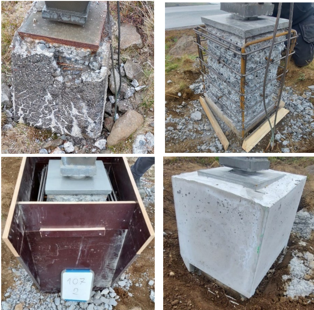
MYND 1 Viðgerð á frostskegmdri undirstöðu í BR1. Framkvæmd með mastur uppistandandi.
