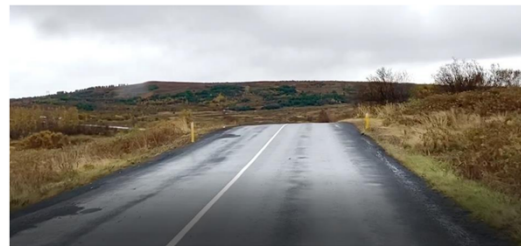
MYND 9 Skert vegrinn áður en komið er að Vífilisstaðalek vegna hæðarlegu vegar, ekið í norður októ. 2020.
